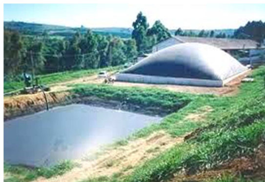
Biodigestor com cúpula móvel
